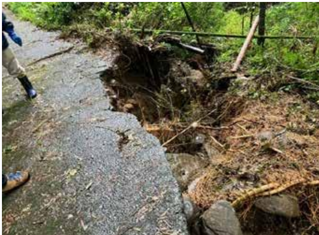
嶺の子山荘への道路も山からの水で崩壊した
