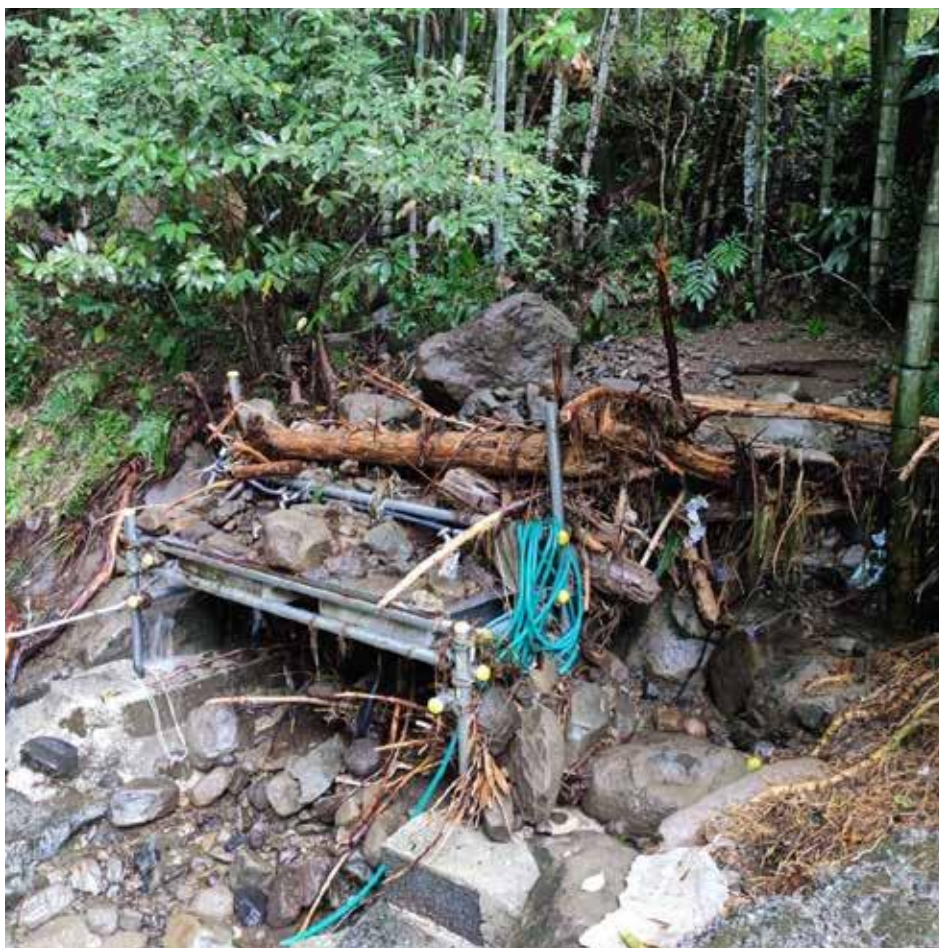
台風15号により嶺の子山荘も被害を受け、沢の土砂で埋まった水道施設
