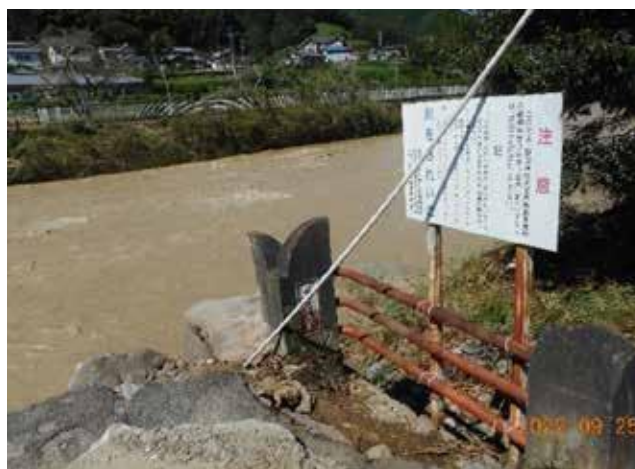
今回の洪水により崩壊し失われてしまいました
