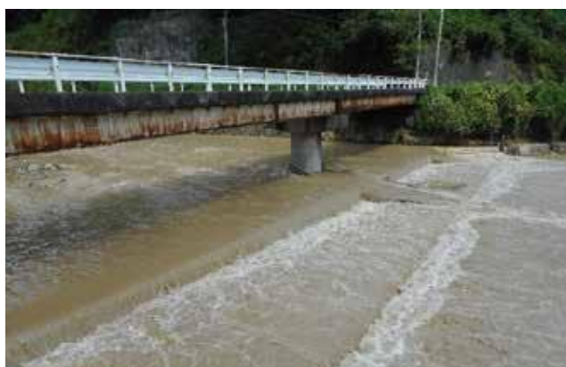
堰堤は多くの土砂が堆積して埋もれてしまっている
