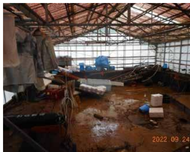
おとり施設内にも浸水し、機材が散乱にした。
