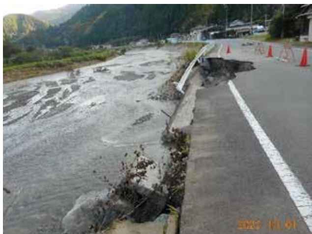
河川沿いの道路も各所で崩壊し、一時通行止めに
