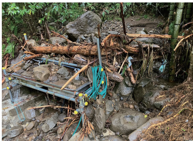
沢の中の水道施設は、土石と流木に覆われた みんなで汗かき復旧作業
