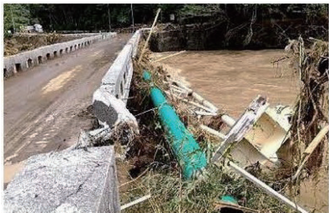
宮島水管橋（緑色の水管）が落橋し、送水できなくなる
