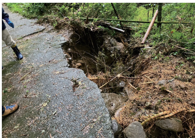
嶺の子山荘への道路が崩壊して危険な状態に
